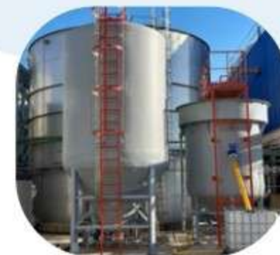
PRÉTRAITEMENT DES EAUX USÉES
